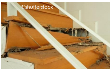
Escalier fortement fragilisé par des termites
